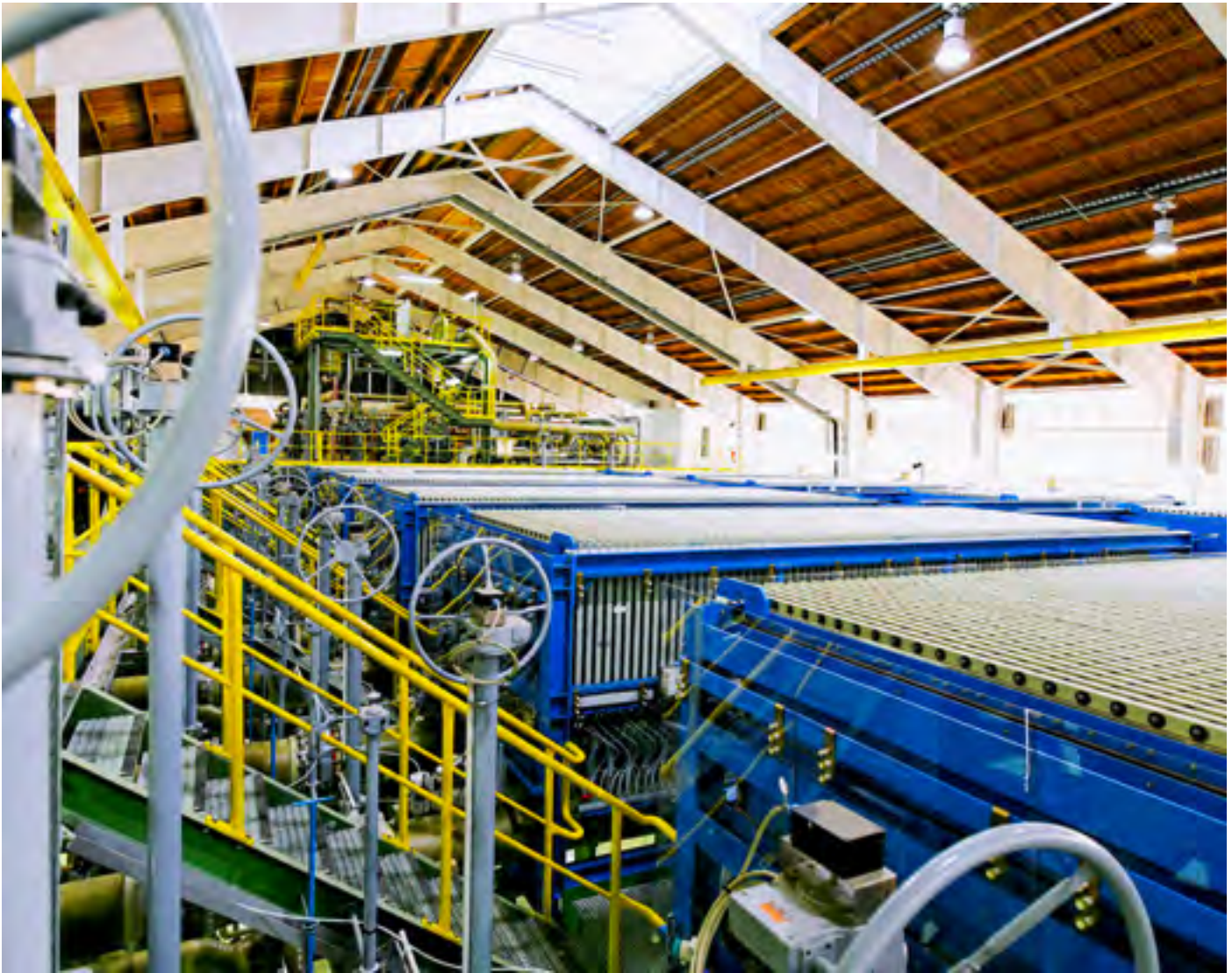
Zellensaal bei Vestolit in Marl. Riesige Energiespeicher für die Energiewende.
